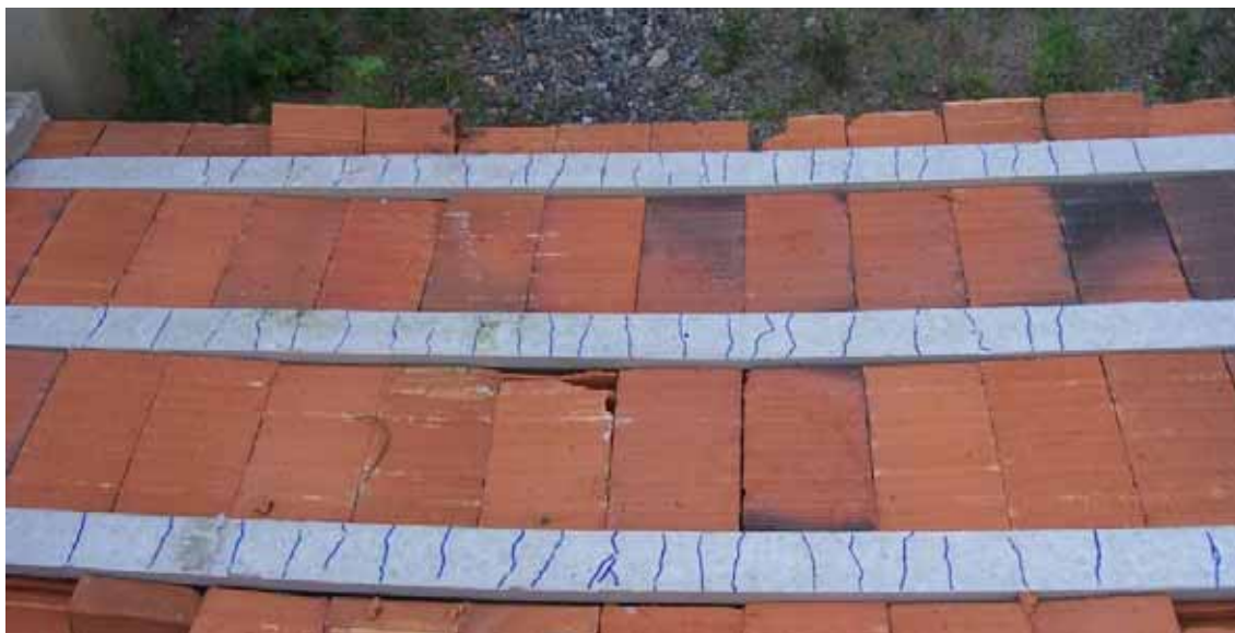
Figura 75 - Fotografia da laje RCD-100% fissurada
