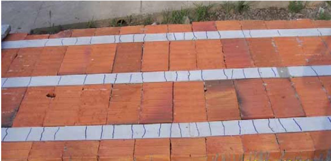
Figura 73 - Fotografia da laje RCD-50% fissurada
