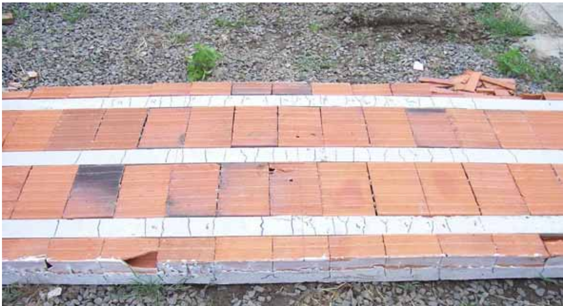
Figura 71 - Fotografia da laje de referência fissurada
