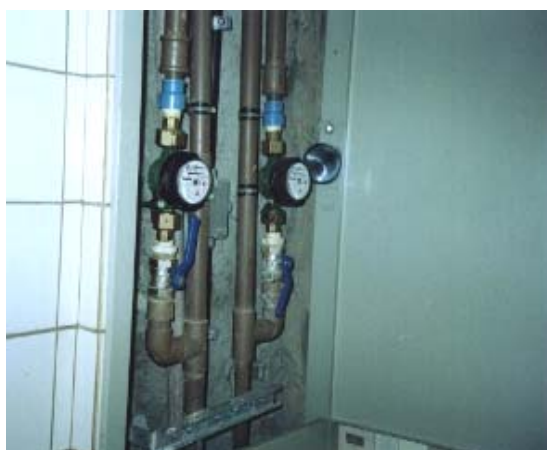
FIGURA 5 – Shaft com os hidrômetros próximos
