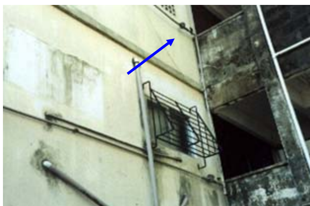
Figura 1 – Hidrômetros instalados na fachada.
