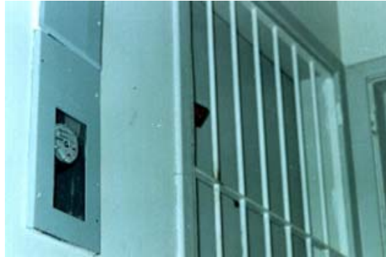
Figura 2 – Hidrômetros instalados na posição vertical.
